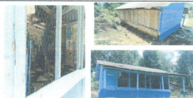
Foto 2: Ventana; La ventana en mal estado por el deterioro del material
