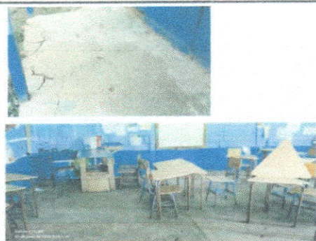
Foto 3: Piso; El piso en mal estado por el tipo de trabajo y material que presenta
