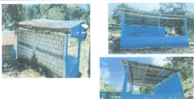
Foto 5: Escenario; El escenario presenta riesgo por la estructura y el techo deteriorado
