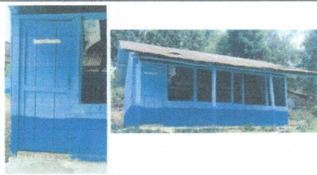
Foto 4: Puerta; La puerta presenta inseguridad
